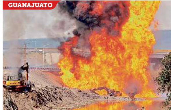
La perforación accidental de un ducto de gas natural provocó una explosión en Celaya.
